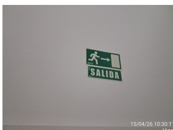
Exit signs (2).jpg
